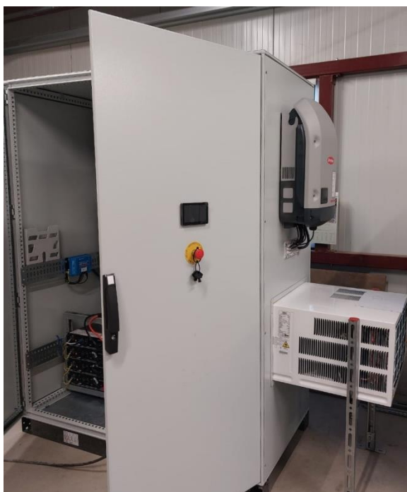
Figure 2 : Armoire triphasée Hybrid Box
