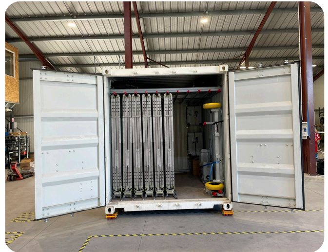
Sistema de racking – lado almacenamiento del Solar Wings ®
