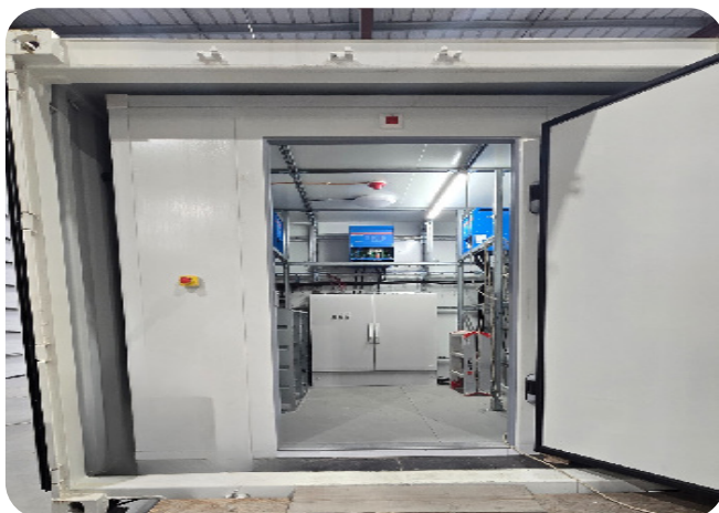
Sala técnica - Almacenamiento de baterías y conversión
