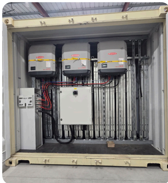
Contenedor On-grid con unidad de conversión
