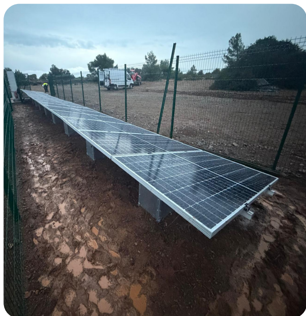
Central FV en suelo - estructura lastrada
