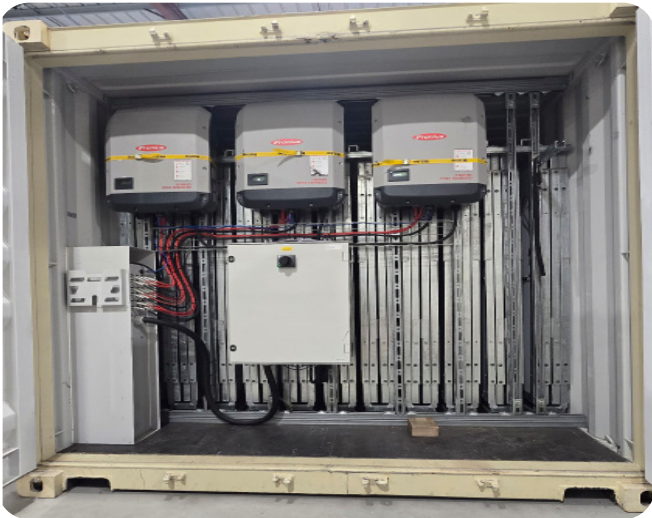
Salle technique - stockage batteries et conversion
