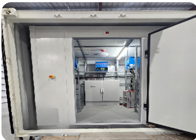
Salle technique - côté stockage
