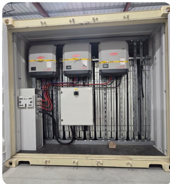
Container On-grid avec unité de conversion
