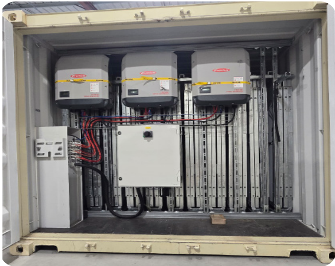
Technikraum mit integrierten PV-Wechselrichtern
