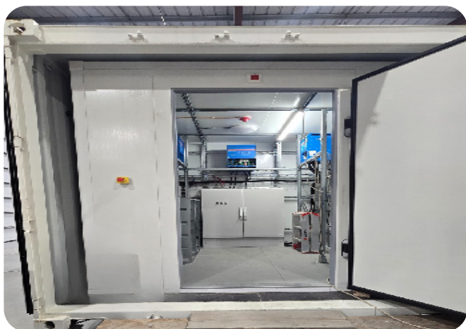
Technikraum mit integrierten PV-Wechselrichtern
