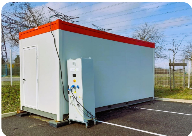
Frame-Watt® 6S auf mobilem Raummodul mit Solar-Hybrid-Box® zur autarken Energieversorgung
