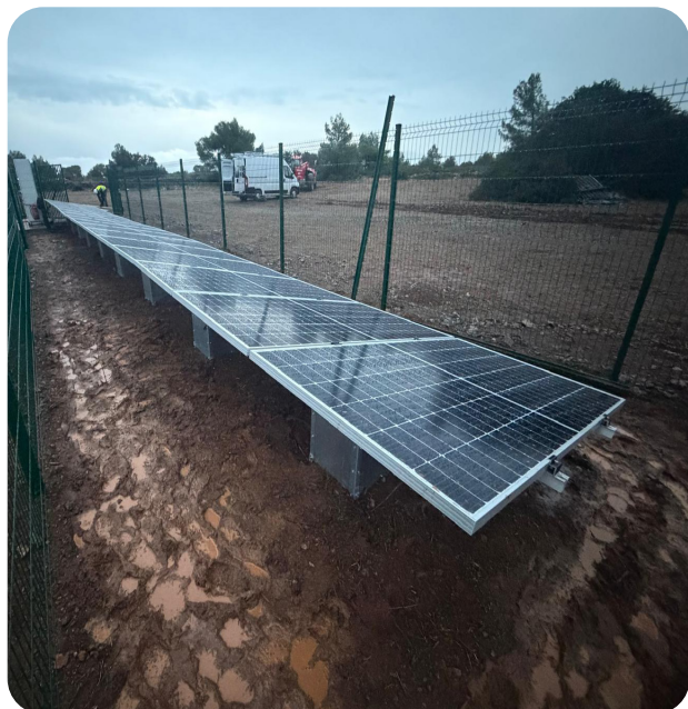
Freiflächen PV-Anlage – Ballastsystem
